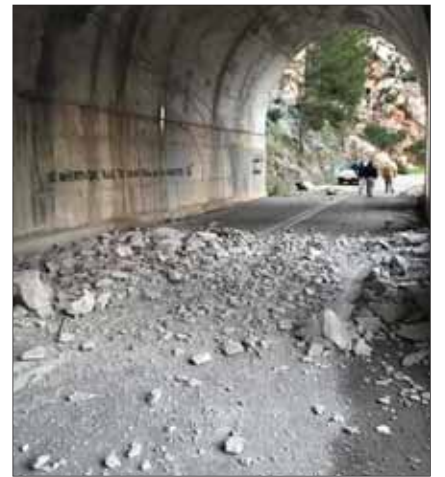
Imagen del material caído en el interior del túnel en la carretera Ma 10.
