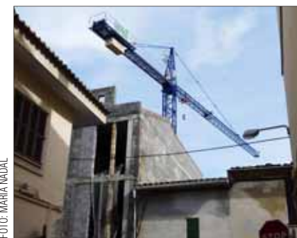
Grúa de obra en sa Pobla. El Consistorio de sa Pobla podrá retirar una grúa de obra que se alza desde hace unos siete años junto a un edificio inacabado.
