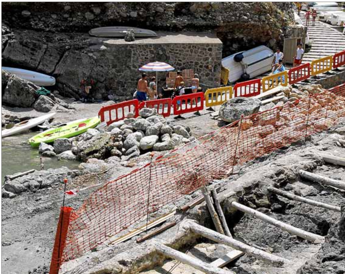
Imagen de las obras que ayer se estaban llevando a cabo en la cala.
