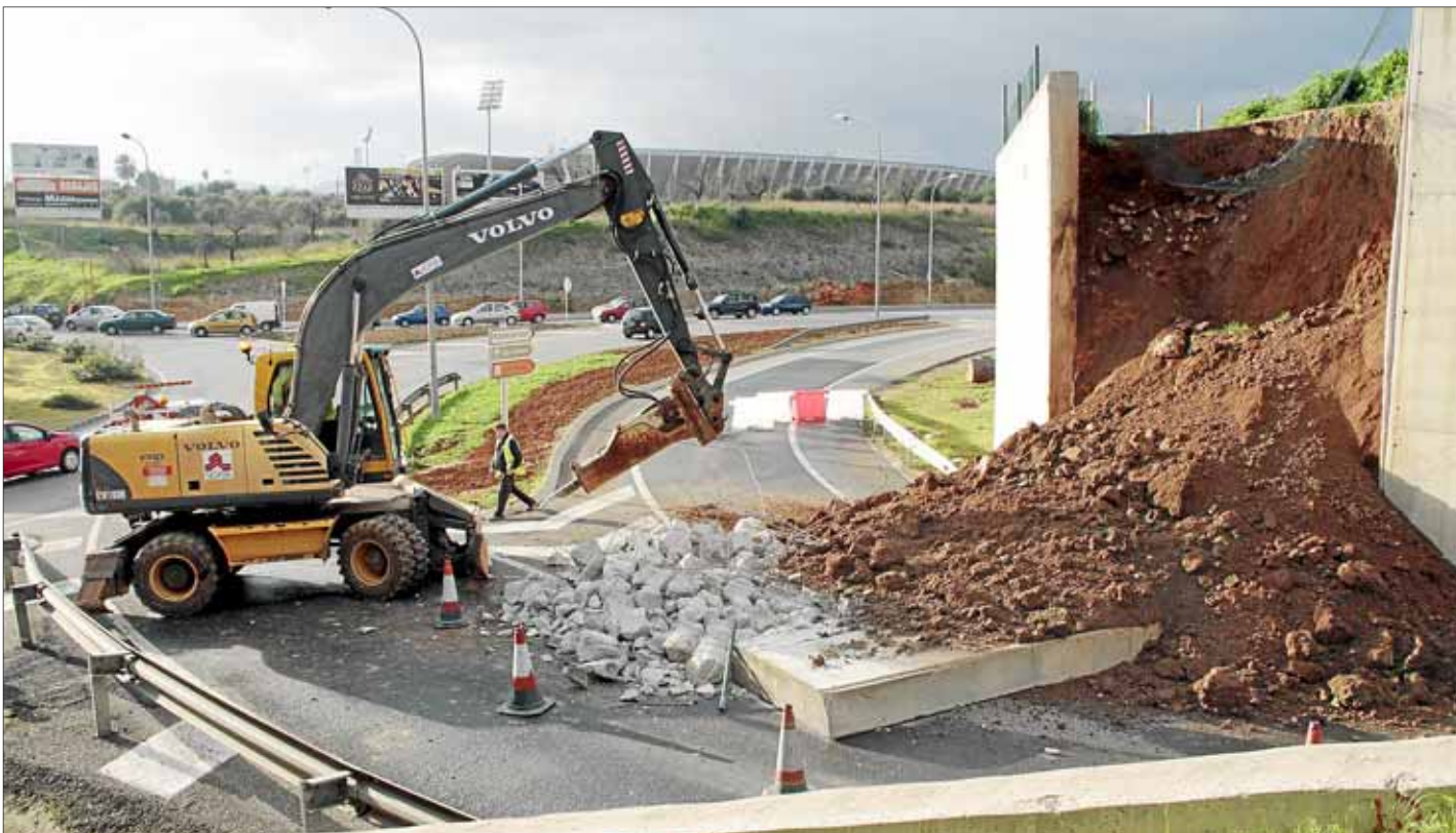
El carril permanecerá cerrado al tráfico rodado durante unos 15 días, mientras duren las tareas de reparación.
