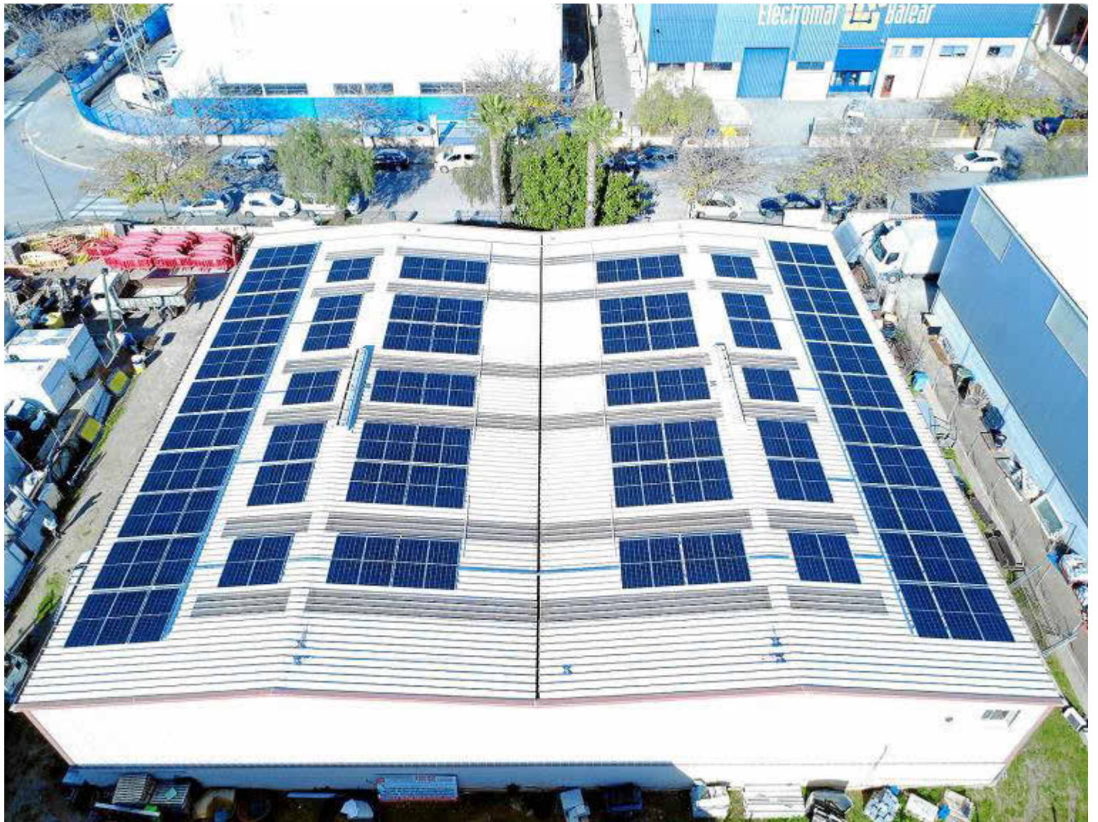
La nave que alberga a la brigada municipal ya dispone de una instalación fotovoltaica que permite el autoconsumo.
