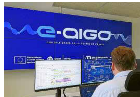
Centro de control e-AIGO, en las oficinas de Veolia en Calvià, donde se centralizan los datos del ciclo del agua.
