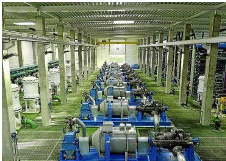
Interior de la IDAM de Bahía de Palma, principal planta desalinizadora de Mallorca, con capacidad máxima de 64.800 m³ día mediante nueve líneas de ósmosis inversa avanzada.
